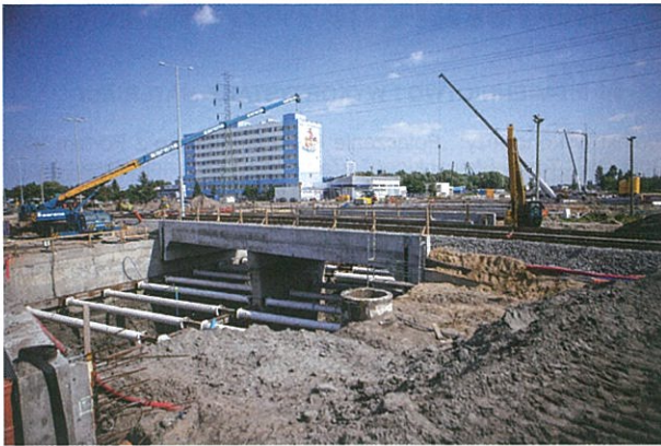
Rys. 17. Wiadukt tramwajowy z ułożoną nawierzchnią torową oparty na ścianach szczelinowych i baretach
