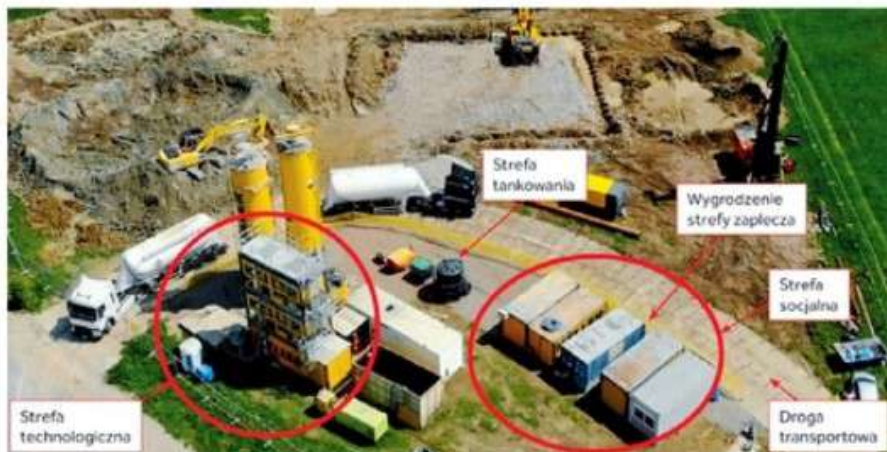
Przykład rozmieszczenia elementów zaplecza budowy geotechnicznej, fot. Keller Polska Sp. z o.o.
